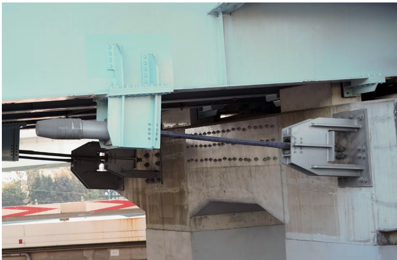
Equipamiento sísmico de un puente ferroviario.
